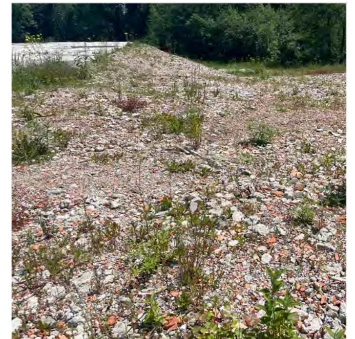
⑫ Espace démolì, problème d'inondabilité avec la rivière.
