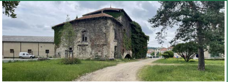
Photographie de l'ancien moulin en mauvais état.
